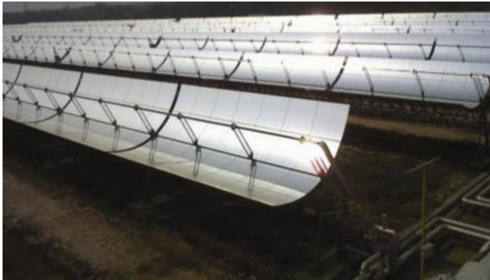
FIGURA 14: CAMPO SOLAR DA PLANTA TERMOSOLAR EM MUMBAI
