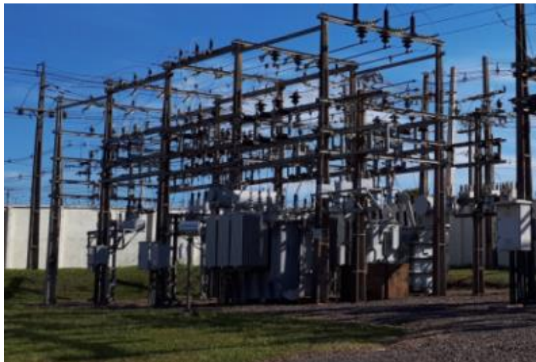
FIGURA 11 - SUBESTAÇÃO TÍPICA DE 34,5 KV
