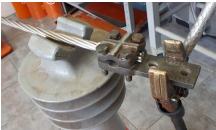
FIGURA 26 - IMAGEM DO CONECTOR TIPO CHAPA-CABO RETIRADO DE OPERAÇÃO
